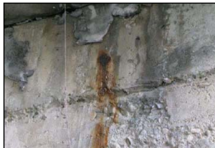
■ コンクリートの落下
