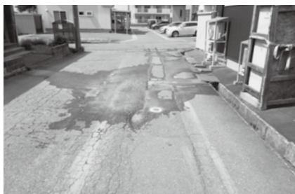
漏水による路面の水ぬれ
