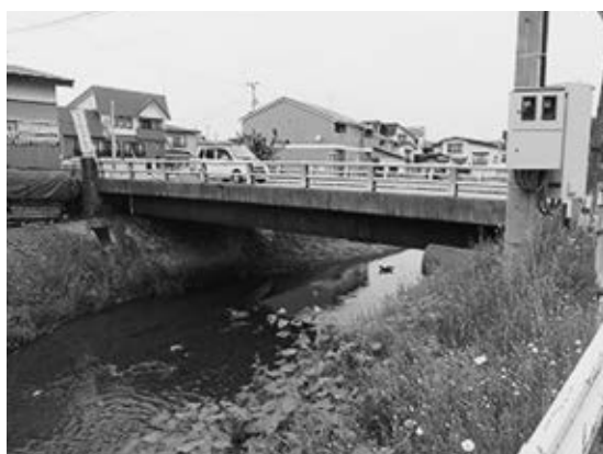
修繕工が必要な橋の状況
