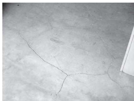
ひび割れた市役所の廊下
