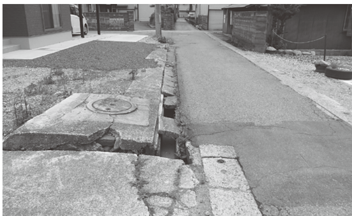
補修が急がれる箇所
