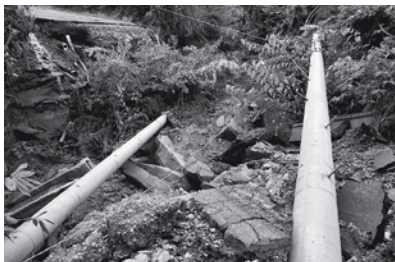
▲道路の寸断(本合海地内)
