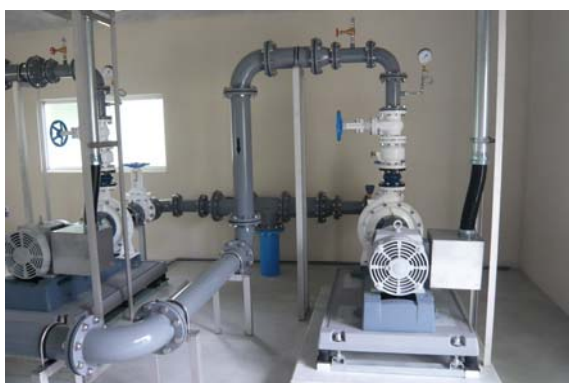
指野浄水場 機械設備
