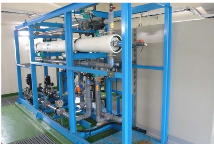
畑浄水場 膜ろ過設備
