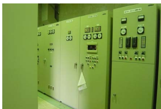
指野浄水場 電気設備
