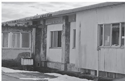
神室荘 老朽化した南側廊下・居住部分
