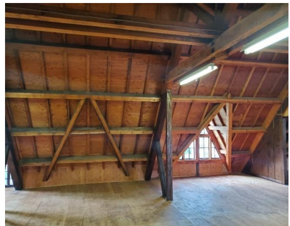
ドーマ窓が撤去された跡
